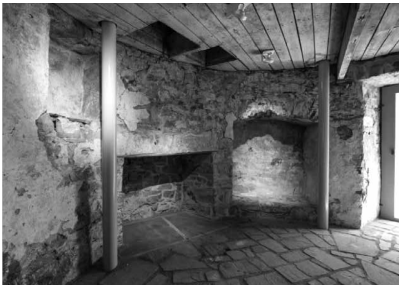
Intérieur du rez-de-chaussée du moulin après les travaux de 2013-2014 (Photographie de la Ville de Québec).
